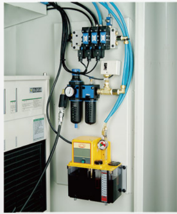
三點組合空壓控制器: 採用歐美進口空壓控制器, 提供更精確、穩定的空壓。
